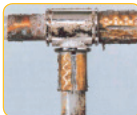
Nalisovaný spoj mosaz-plast. Trhliny způsobené procesem koroze pod napětím. (3)
